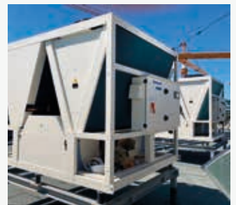
Cédrus Liget. Gebäudekomplex mit Apartments, Büros, Geschäften usw. Szeged, Ungarn. ECOi-W, ECOi + Lüftungseinheiten mit Wärme- und Feuchterückgewinnung
